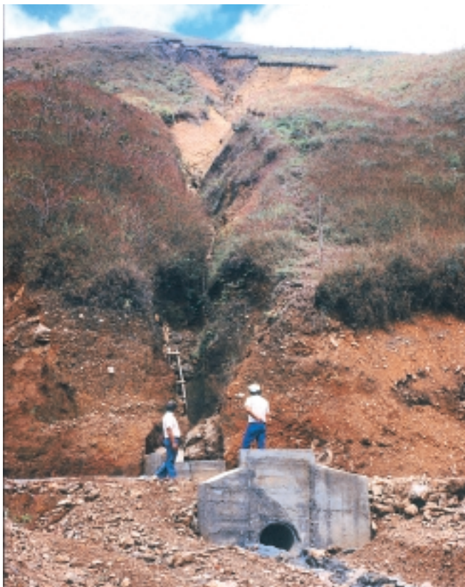
Cárcava con trabajo de recuperación.
