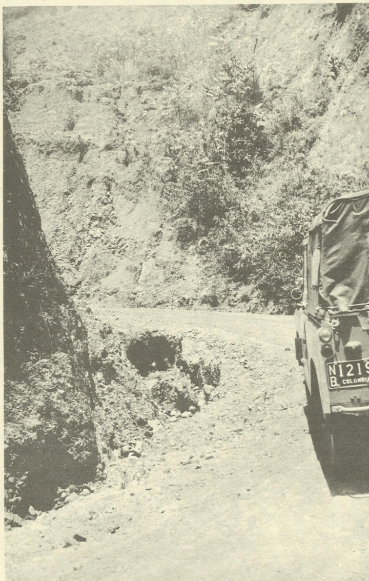
FOTOGRAFIA # 25. Cárcava lateral de la vía, iniciando el proceso erosivo de la banca por efecto del agua de escurrimiento superficial.
