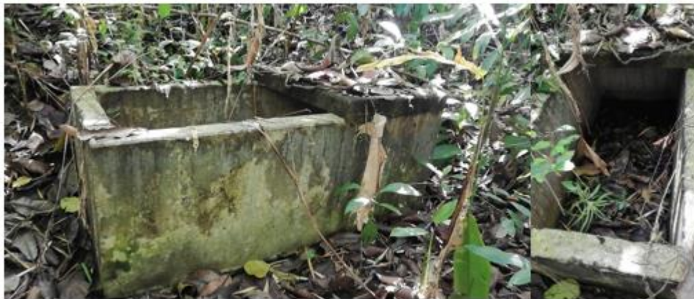
Figura 27. Tanque de captación no operativo, comunidad Cueva Loca. 30-oct-2021
