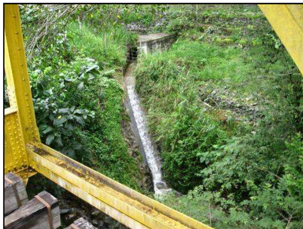
Foto 8.9 Quebrada Cola de Gurre 1 en el Puente El Molino o Ferrocarril, desembocando al río Dagua – Frontera aguas abajo.
