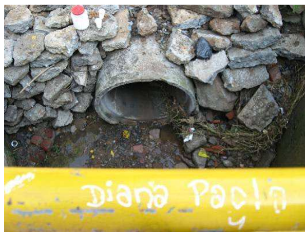
Foto 8.10 Quebrada Cola de Gurre 1 fluyendo por una tubería de aguas residuales.
