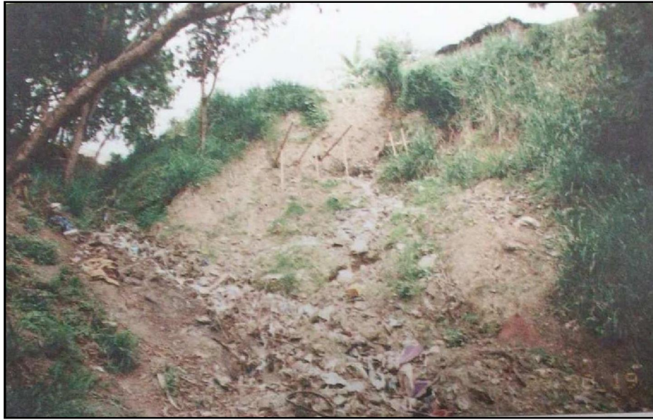
Foto 5.15 Deslizamiento en el barrio de Alto Bonito. (Tomada del Informe Técnico de CVC No 1130-05-028-212 de 2001)
