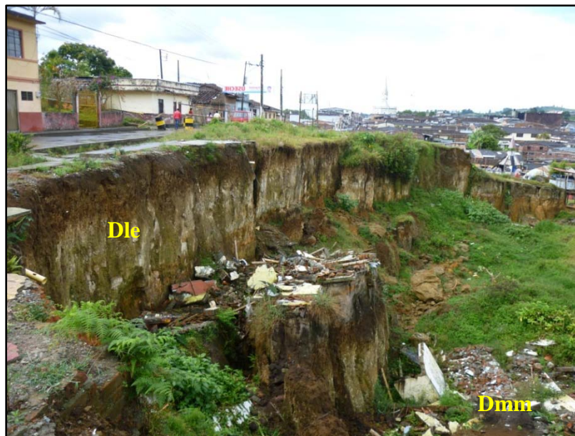
Foto 5.5 Zona escarpada (Dle) y con movimiento en masa (Dmm) en la corona del deslizamiento del barrio Monserrate.
