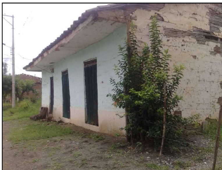
Foto 3.4 Viviendas en mal estado estructural. Avanzado deterioro de los elementos portantes, presentándose desniveles en toda la estructura. Agrietamiento de las paredes por acción de la intemperie.
