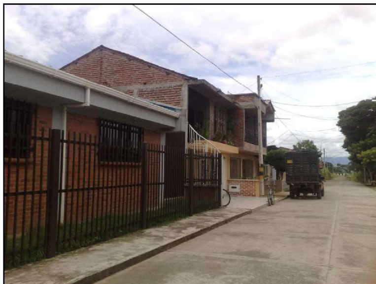
Foto 3.3 Viviendas en buen estado estructural. Los elementos portantes (vigas, columnas y muros estructurales) no presentan fisuras ni grietas; tampoco se encuentra deteriorada por efectos de intemperización.
