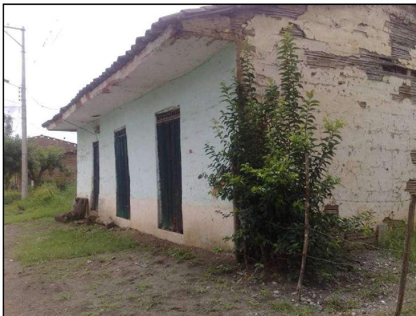
Foto 1 Estado de la vivienda en avanzado deterioro estructural. Barrio el Lago
