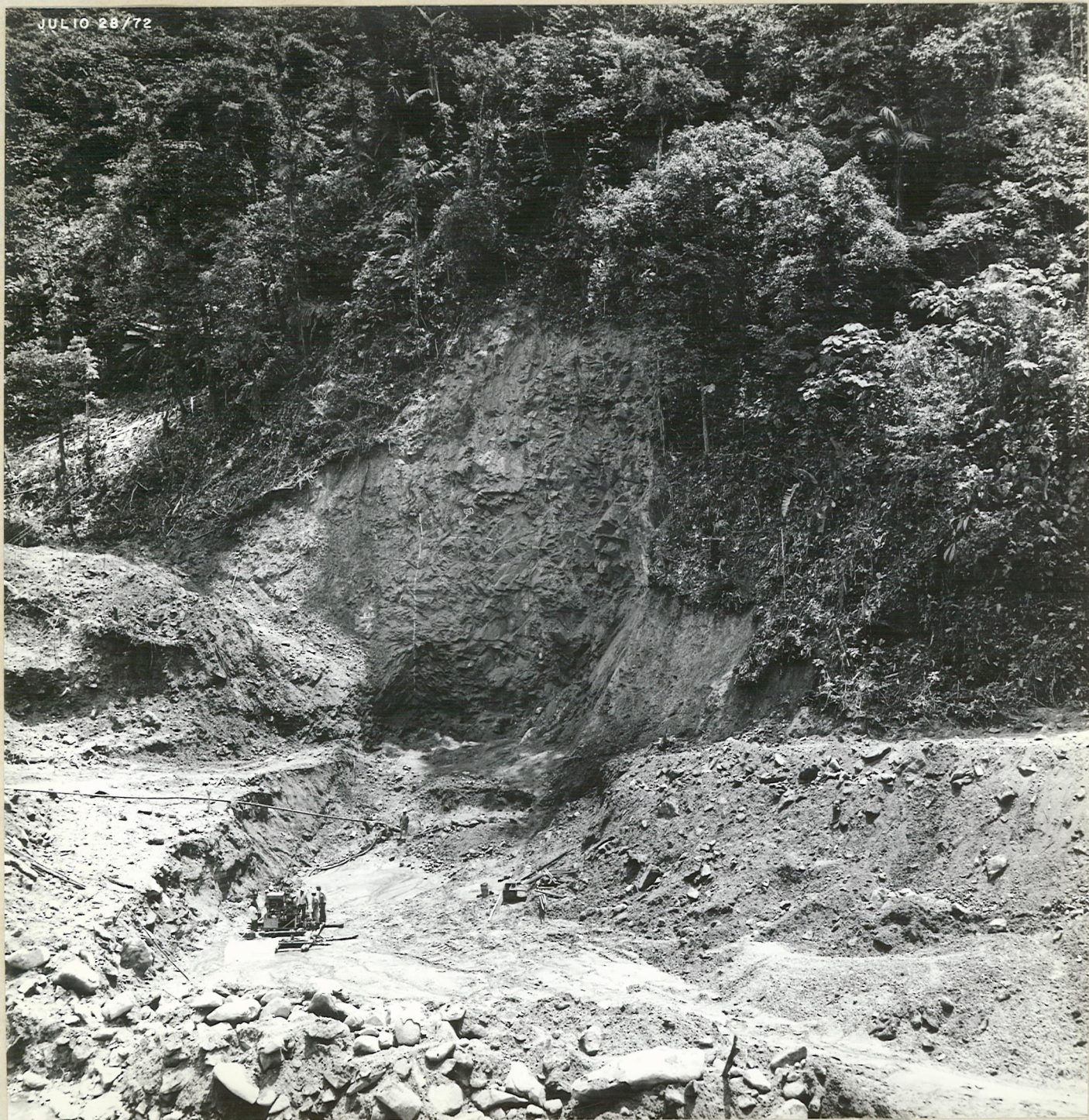
4.- CAPTACION MURRAPAL Excavación en el Lecho Izquierdo del Río y el Estribo Izquierdo
