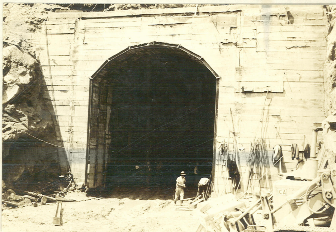
3. PORTAL CASA DE MAQUINAS
