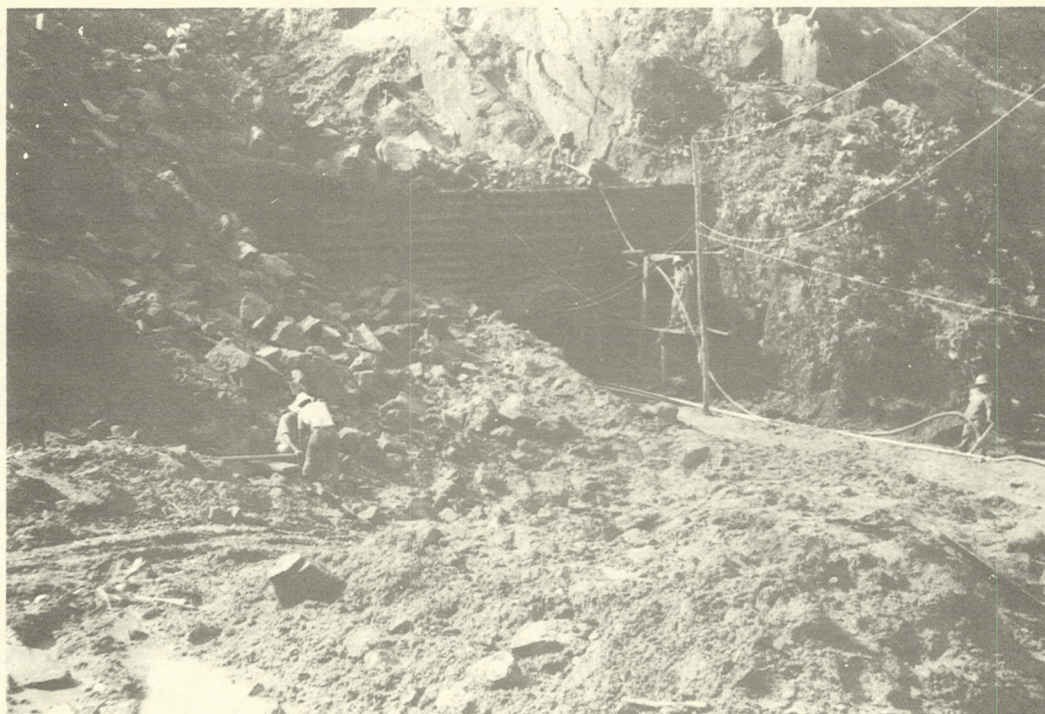
FOTOGRAFIA # 9: CASA DE MAQUINAS Ampliación túnel de exploración CM-2.
