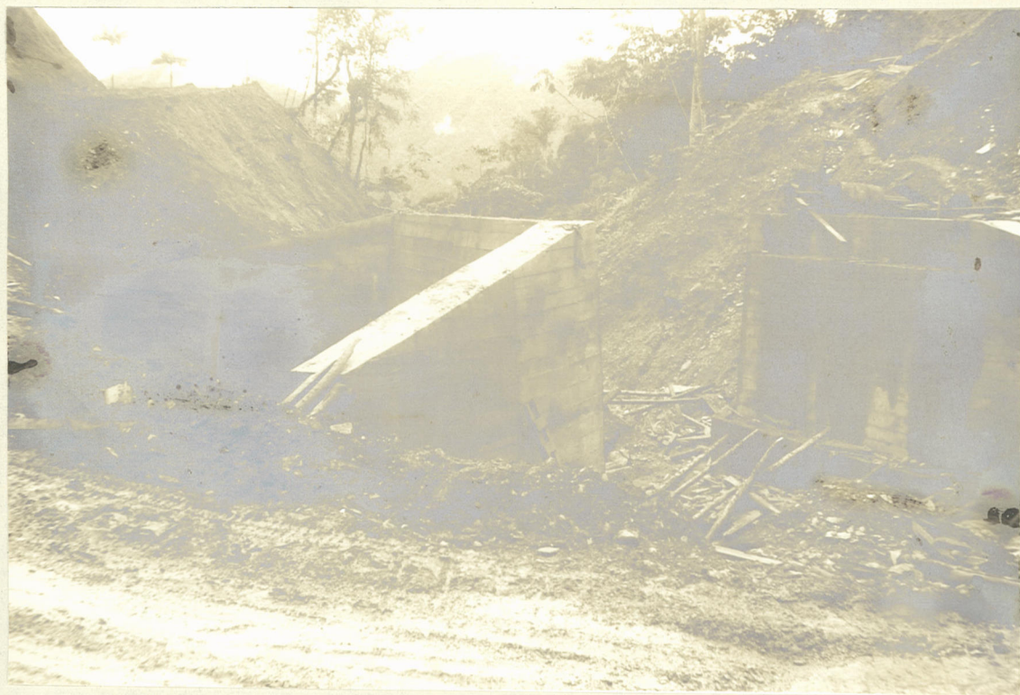
Nº 2 CARRETERA PRINCIPAL DE ACCESO Puente sobre la Quebrada La Cristalina Estribos terminados.
