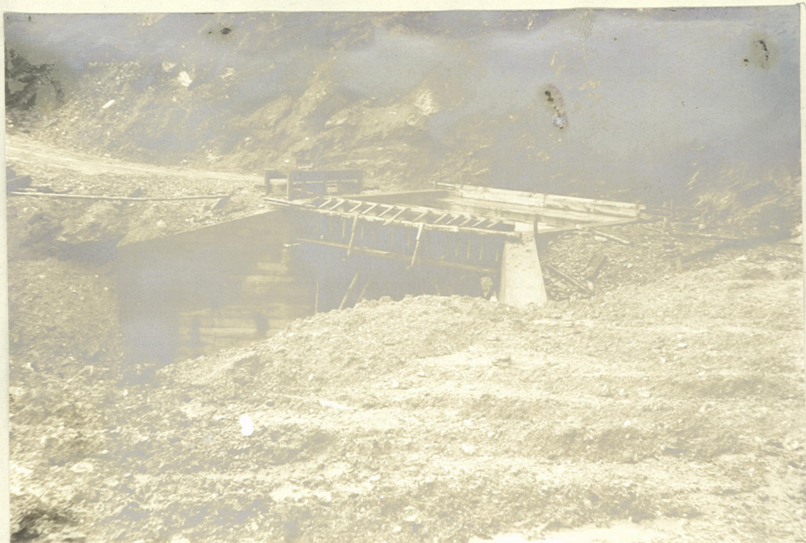
Nº 1 CARRETERA PRINCIPAL DE ACCESO Puente sobre la Quebrada La Loca Losa lista para vaciado de concreto.
