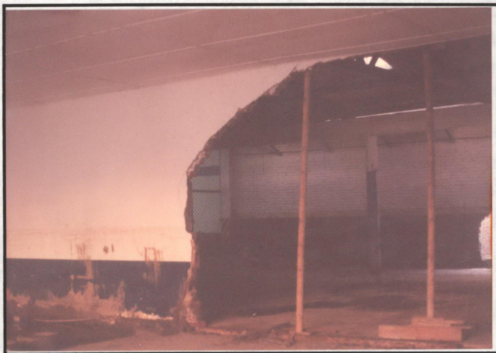
Fotografía 7.7. Los muros de ladrillo no oponen mucha resistencia a la dinámica de un fenómeno como las avenidas torrenciales. (ej. Avenida del río Guadalajara, Buga 1997).
