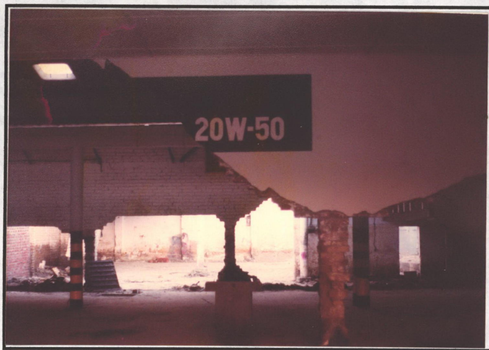
Fotografía 7.14. Daños en muros causados por un flujo de materiales de grano medio a fino, a gran velocidad. (ej. Avenida del río Guadalajara, Buga – 1997).
