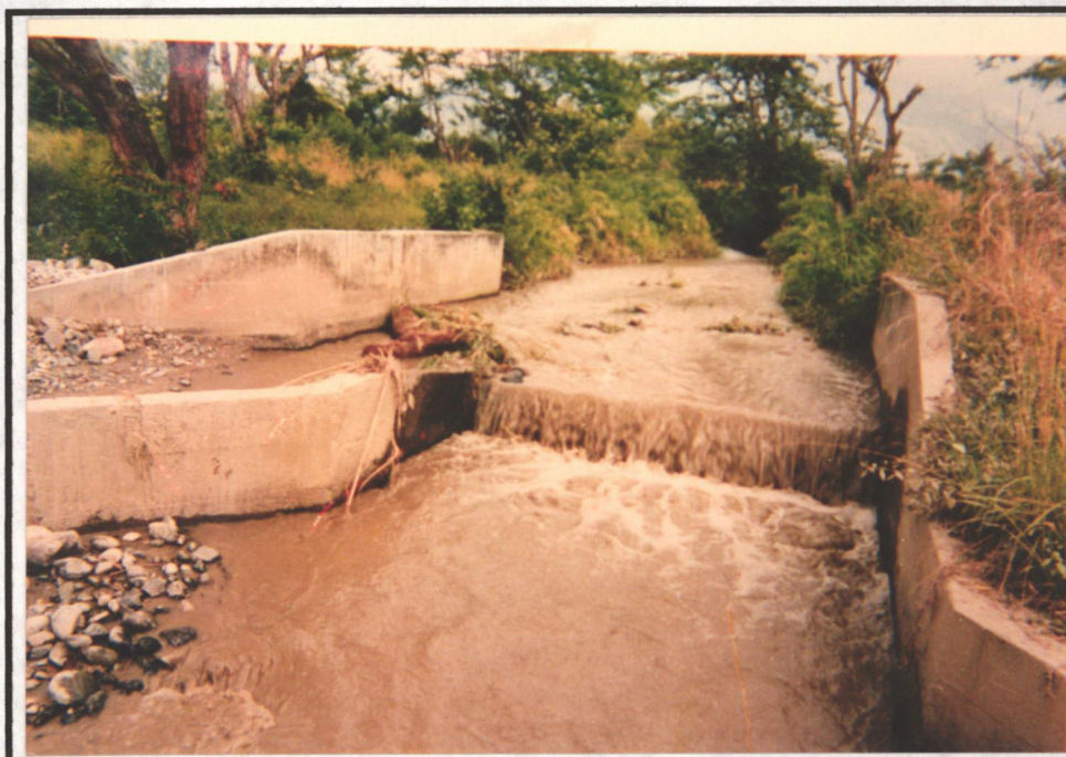
Fotografía 7.9. Canal para riego y suministro de agua a la población de Pradera. La gran mayoría se encuentran sin ningún tipo de recubrimiento; aunque éste posee estructura por ser el punto de desvío para la planta de tratamiento.
