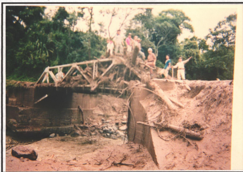
Fotografía 7.18. Puente sobre el río Bolo, que comunica a Potreritos con el municipio de Pradera. Obsérvese la acumulación de material luego de la avenida de 1994.
