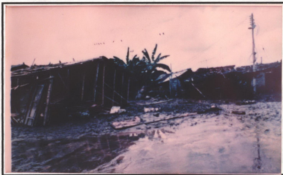
Fotografía 7.17. Estado en que quedaron algunas viviendas (ejemplo, municipio de Florida en la avenida de 1994). Materiales constitutivos y estructuras bastante débiles
