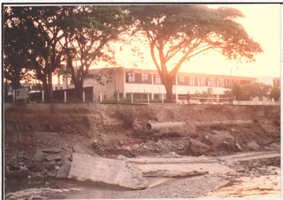
Fotografía 7.19. Nivel de daño en las conducciones. (ej. Avenida del río Guadalajara, Buga – 1997).
