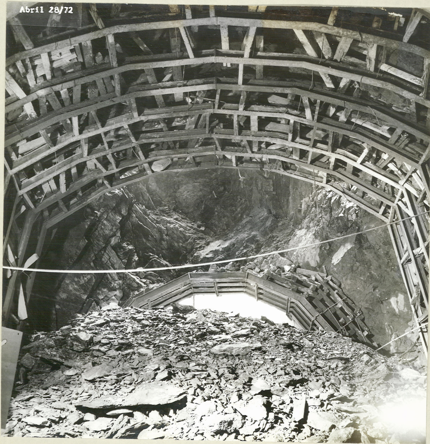
2. TUNEL DE DESVIACION Desprendimiento de roca en el pozo de compuertas
