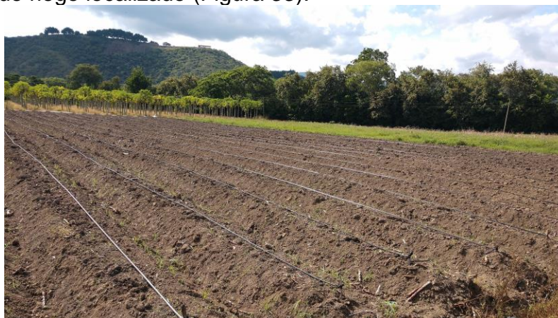
Figura 33. Instalación sistema de riego localizado de alta frecuencia sobre camas de siembra, cuenca RUT (La Unión).
